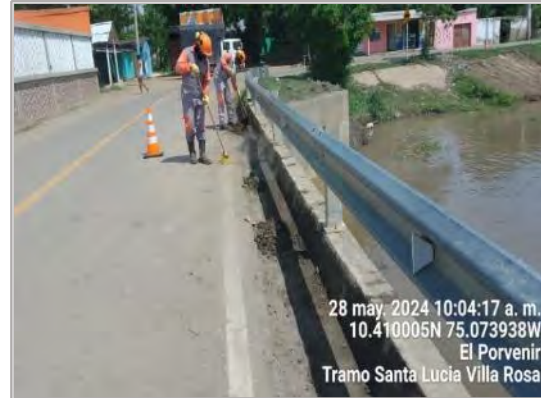
Fotografía 20. Limpieza de defensas metálicas y señalización horizontal- Tramo Santa Lucía – Villa Rosa.
